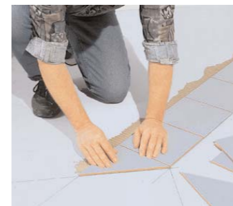
9 So erhält man einen 45-Grad-Winkel und kann entsprechend problemlos die Fliesen zuschneiden, ...
