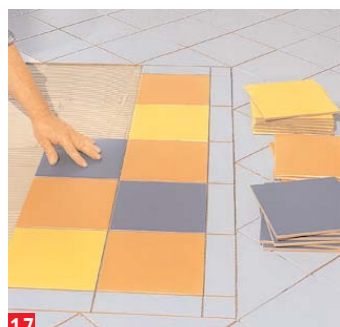
17 Anschließend dürfte es dann kein Problem sein, die restliche Fläche mit den Fliesen zu belegen
