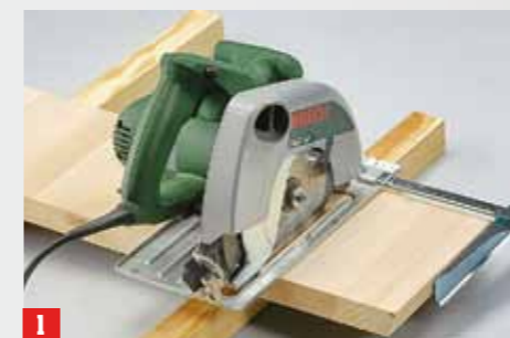
1 Schneiden Sie die Regalteile auf Gehrung (45°-Winkel) und nutzen drei Teile; das vierte Element wird gekürzt
