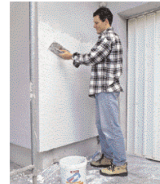
17 Prima di passare la mano preliminare con il colore di fondo bianco, talocciate la malta rasante con la cazzuola
