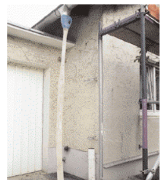
Provisorische Entwässerung mit Trichter und Schlauch während der Bauphase
