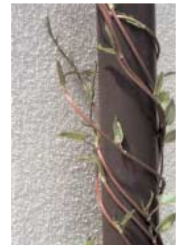
Schlingknöterich mit Schlingen an Dachrinne
