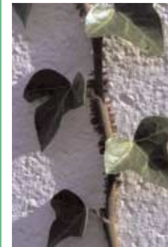
Efeu mit Haftwurzeln auf Mauer- werk
