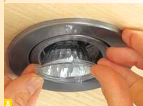
8 Se tutto funziona applicate l'anello di plastica contenuto nel set di faretto che serve a fissare le lampadine nel portalampada
