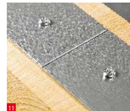
11 La lamina levigata larga 50 mm viene fissata con viti a testa tonda di 3,5 mm.
