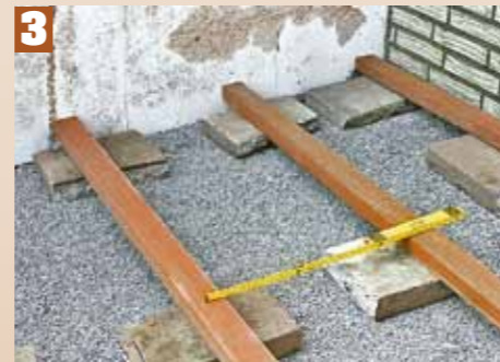
3 Des plaques en béton ont été choisies comme soutien du soubassement de la construction. Elles porteront tous les 40 à 50 cm un bois équarri.
