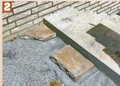
2 La hauteur de la marche supérieure de l'escalier a été prise en considération avant la pose déjà.
