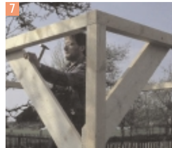
7 La structure de bois ne sera absolument stable qu'après la pose de contrefiches qui peuvent être des planches fixées avec des clous ou alors des chutes de carrelots.
