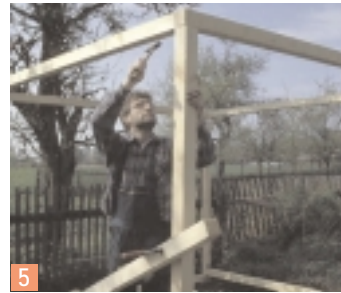
5 La structure en bois prend rapidement forme. Les entretoises sont également fixées avec des plaques d'angle. Une appui provisoire assure la stabilité momentanée.
