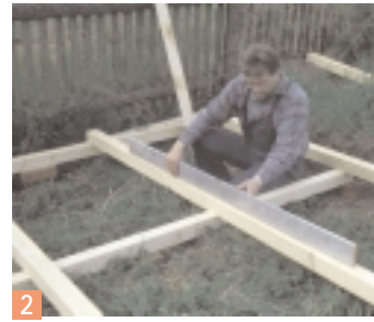
2 Un contrôle au niveau est encore une fois nécessaire. Si nécessaire, la structure en bois peut être facilement remise à niveau avec des cales en bois.
