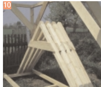
10 Pour ce cabanon, 4 éléments assemblés suffisent: un pour chaque pignon et deux dans l'espace intermédiaire pour soutenir les lattes du toit.
