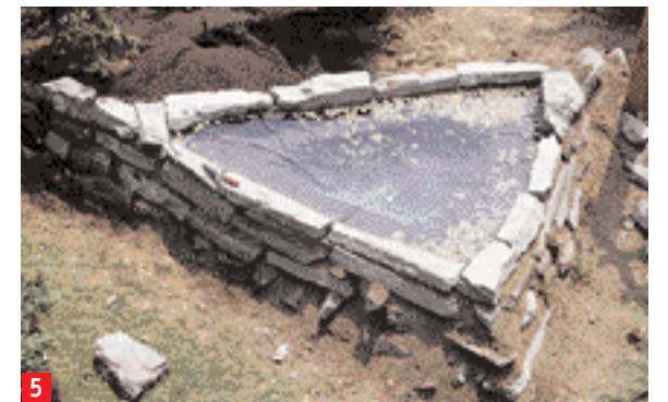
5 Le bassin est terminé. Derrière lui, une plate-bande à bruyère surélevée sera créée, en partie avec la terre provenant du creusement de l'étang.
