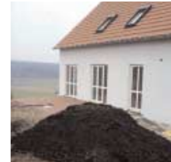
Après la construction de la maison, se procurer de la terre végétale et la répartir sur toute la surface.
