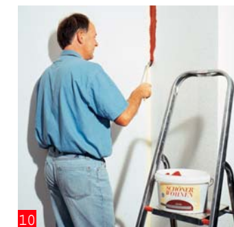
10 Beginnen Sie mit dem Heizkörperpinsel in den abgeklebten Ecken. Ziegel heisst die Trendfarbe, die ...
